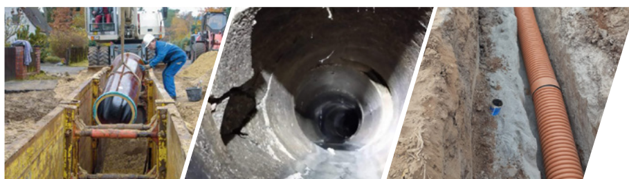
Foto 5: Colector de gres vitrificado
